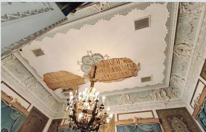
نمایی از خسارت‌های کاخ سبز در کاخ سعدآباد پس از حمله آمریکا و اسرائیل (وضعیت سقف اتاق خاتم، دفتر کار پهلوی اول)
